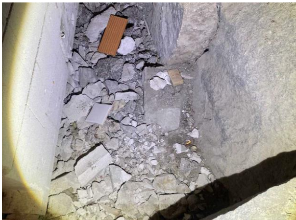
Bild 1: Utvändigt, Grund, Krypgrund betongbjälklag med uppreglade golv. Det saknas fuktavvisande plastfolie på krypgrundens botten.
