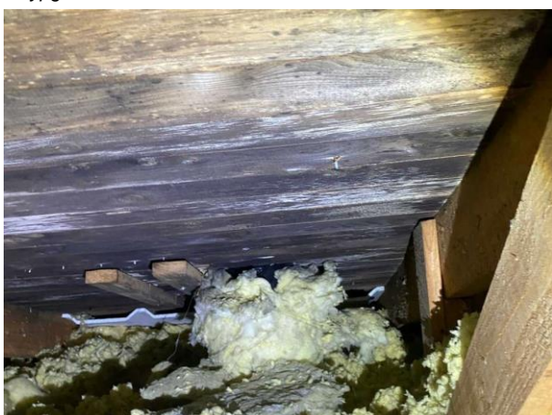
Bild 3: Utvändigt, Vind, Mikrobiell påväxt noterade på underlagstaket (detta är upptaget i en tidigare utförd besiktning). En avlopslukt noterades i slutet av vinden..
