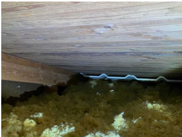
Bild 2: Utvändigt, Vind, Mikrobiell påväxt noterade på underlagstaket (detta är upptaget i en tidigare utförd besiktning)
