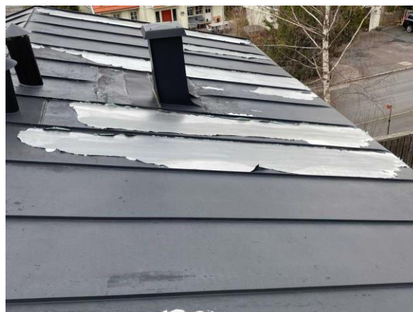
Bild 4: Utvändigt, Yttertak, Färgsläpp finns på takplåtar
