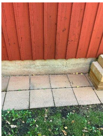
Bild 1: Utvändigt, Grundmur/Hussockel, 2 mindre sprickor i hussockeln
