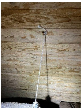
Bild 3: - Utvändigt, Vind, Huset är självdragsventilerat, se riskanalysen Mikrobiell påväxt noterades på del av underlagstak...
