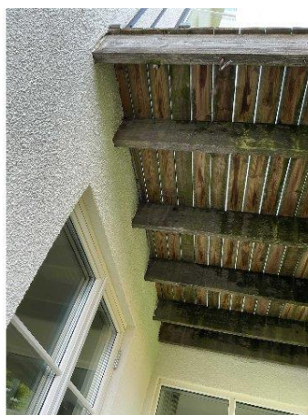
Bild 4: Utvändigt, Övrigt, Förlängda golvåsar till balkongen se riskanalysen
