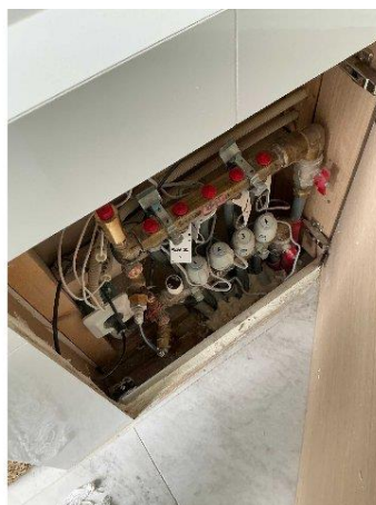
Bild 2: - Invändigt, Övervåning, Renoverat 2025 Undrain golvvbrunn av väggnära modell typgodkänd Tätskikt saknas i inbyggnad för G...
