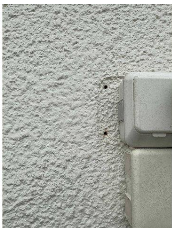
Bild 1: - Utvändigt, Fasad, Borrhål i fasad vid eldosa Spricka i puts hushörn Puts -s.k enstegstätad putsfasad har visat sig...
