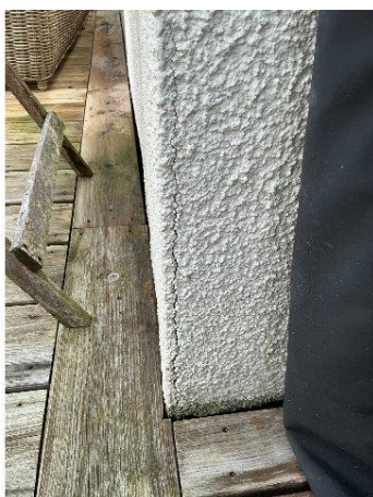
Bild 3: - Utvändigt, Fasad, Borrhål i fasad vid eldosa Spricka i puts hushörn Puts -s.k enstegstätad putsfasad har visat sig...
