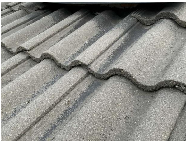
Bild 4: - Utvändigt, Yttertak, Äldre tak se riskanalysen. Taket har besiktats i anslutning till taksäkerhet. Fotplåt saknas mot h...
