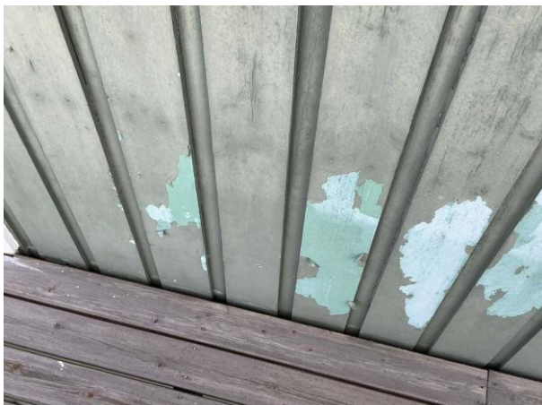
Bild 1: - Utvändigt, Fasad, Färgsläpp målningsskador i panel Lokala rötskador i fönsterfoder Torrspäckor i panel
