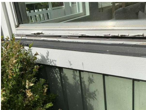
Bild 3: Utvändigt, Fönster, Färgsläpp på fönster
