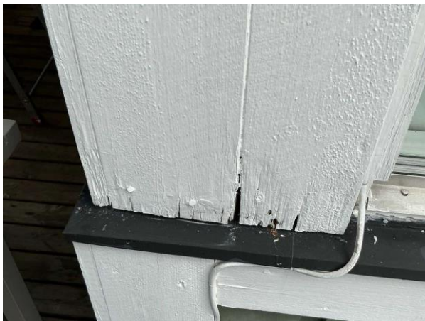
Bild 2: - Utvändigt, Fasad, Färgsläpp målningsskador i panel Lokala rötskador i fönsterfoder Torrspäckor i panel
