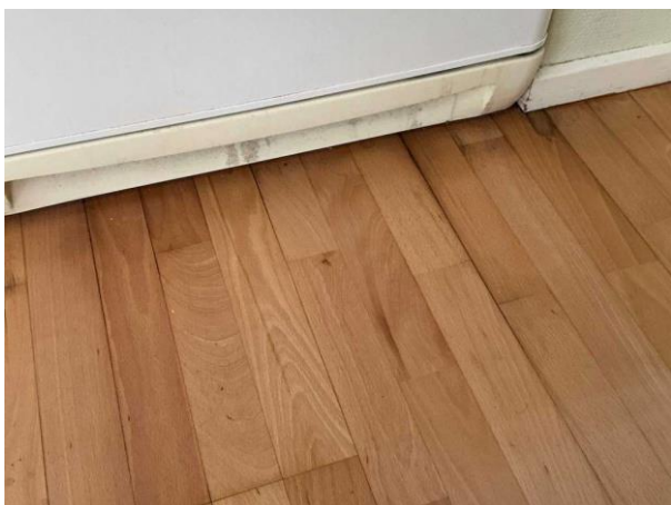
Bild 7: - Invändigt, Övervakning, Fuktmärken i golv under kyl (torra vid besiktningen) Droppskydd saknas under kyl/frys, regler för...
