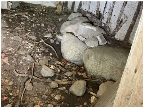
Bild 8: - Utvändigt, Krypgrund, Vatten rinner på grunden från berget Röttskadat mögelskadat virke mot mark Rasskydd av trä är ru...
