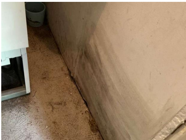
Bild 7: - Invändigt, Entréplan, Tätskikt saknas på golv Viss missfärgning på vägg nedre kant
