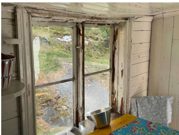
Bild 12: - Utvändigt, Övrigt, Utbyggnad i bakkant är i behov av att rivas Taket läcker och fasaden är rötskadad Utbyggnaden ve...
