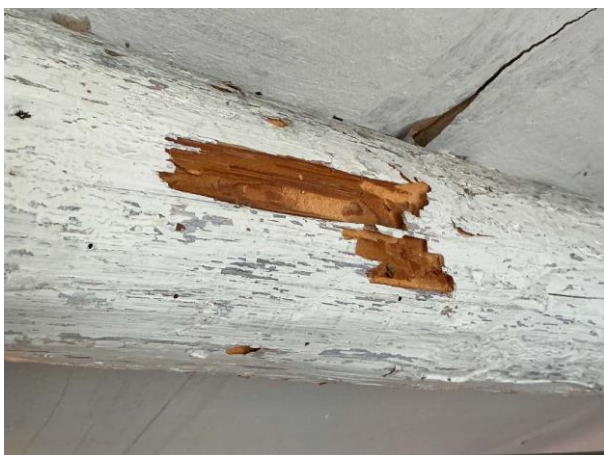
Bild 3: - Utvändigt, Vind, Huset är självdragsventilerat, se riskanalysen Spår av träskadeinsekter noterades på takbjälkar o...
