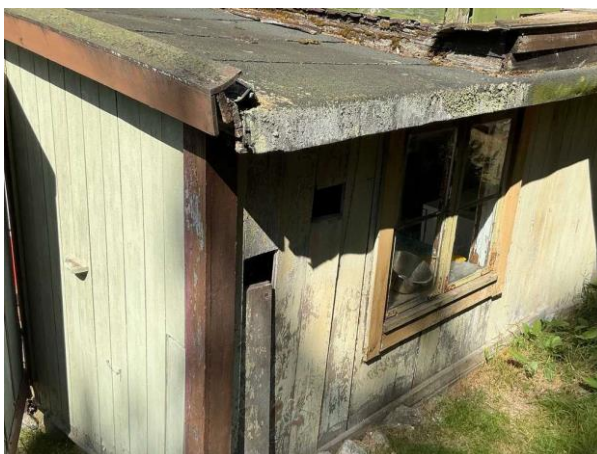
Bild 11: - Utvändigt, Övrigt, Utbyggnad i bakkant är i behov av att rivas Taket läcker och fasaden är rötskadad Utbyggnaden ve...
