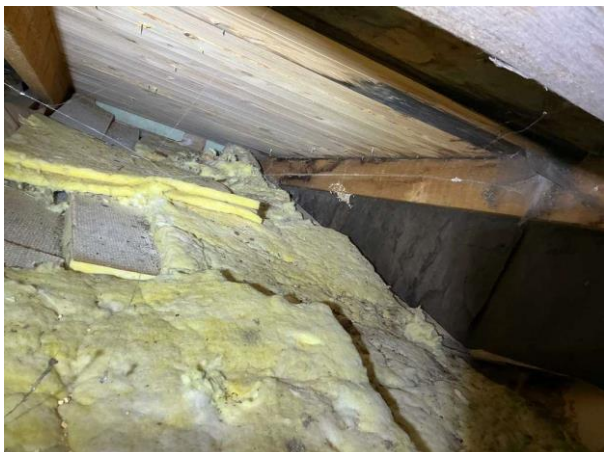
Bild 1: - Utvändigt, Vind, Huset är självdragsventilerat, se riskanalysen Spår av träskadeinsekter noterades på takbjälkar o...
