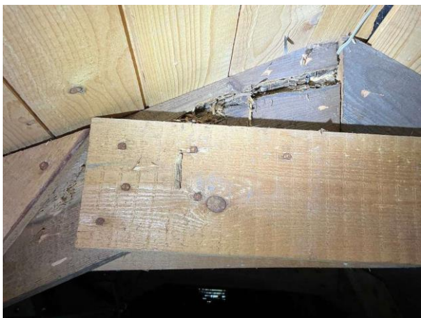
Bild 4: - Utvändigt, Vind, Mikrobiell påväxt noterades lokalt (inringad och daterad) ej förändrats sedan 2023 Rötangrepp i t...
