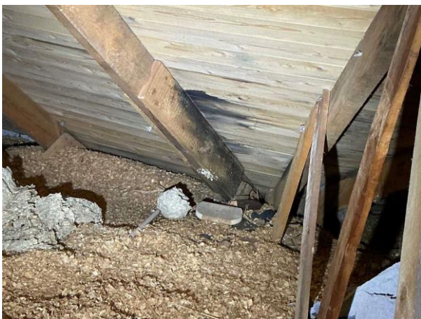
Bild 3: - Utvändigt, Vind, Mikrobiell påväxt noterades lokalt (inringad och daterad) ej förändrats sedan 2023 Rötangrepp i t...
