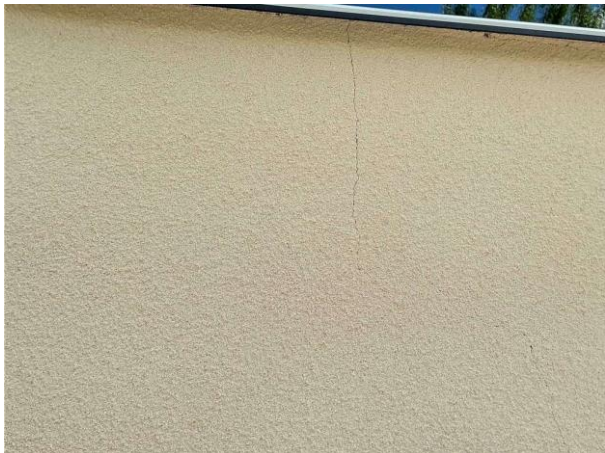
Bild 2: Utvändigt, Fasad, Mindre spricka i fasadputs noterades
