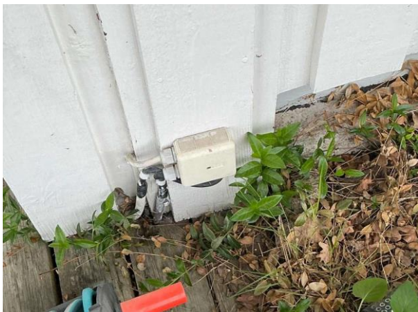
Bild 1: Utvändigt, Fasad, Fasad är delvis marknära och nära altanen vilket kan medföra fuktuppsugning i ändträ
