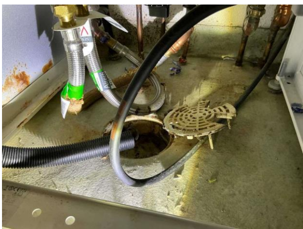
Bild 3: - Invändigt, Souterrängplan, Det förekommer rörgenomföringar i golv för annat än avlopp Klinker lagt ovan äldre plastmatta Gol...
