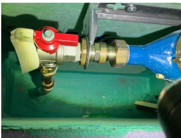
Bild 4: Invändigt, Souterrängplan, Inbyggnad för inkommande vatten är utförd med tät beklädnad och skvallerörr om det uppstår läckag...
