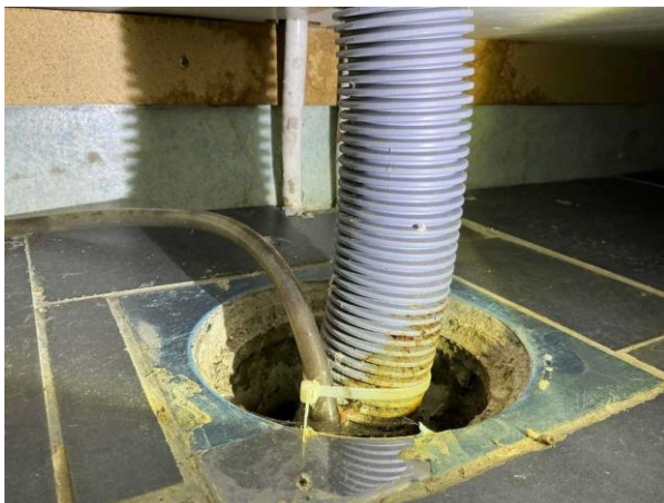
Bild 2: - Invändigt, Souterrängplan, Det förekommer rörgenomföringar i golv för annat än avlopp Klinker lagt ovan äldre plastmatta Gol...
