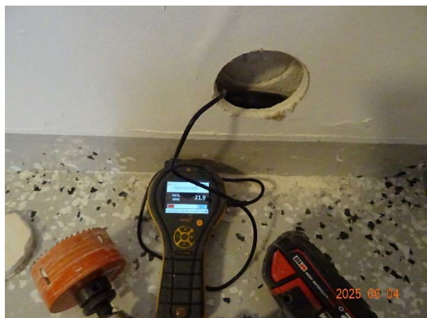
Bild 4: Fuktmätning i vägg, baksidan av garage
