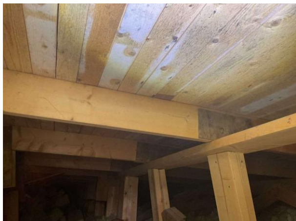
Bild 3: - Utvändigt, Vind, Lokalt noteras mikrobiellpåväxt på underlagstaket
