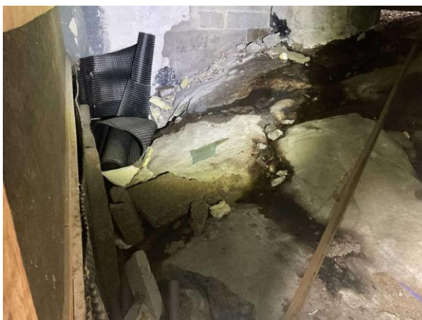
Bild 2: - Utvändigt, Grund, fukt/vatten noteras på berget i grunden bristfälligt monterad platonmatta
