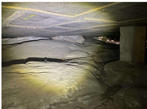
Bild 1: - Utvändigt, Grund, Utluftventilerad krypgrund/plintgrund Fuktavvisande plastfolie saknas marknära plintgrund
