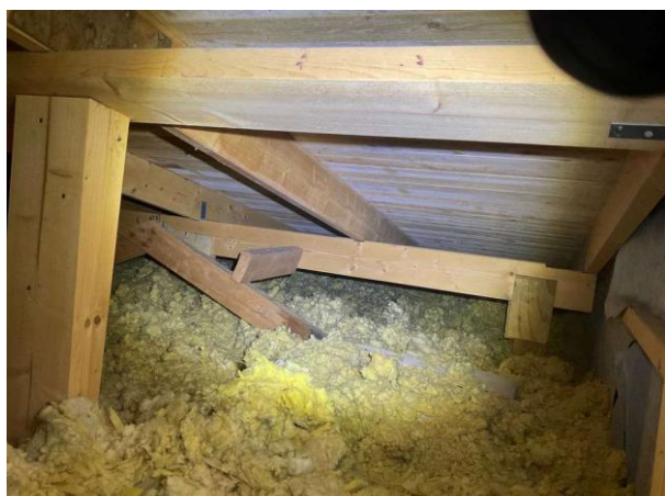
Bild 5: - Utvändigt, Vind, Lokalt noteras mikrobiellpåväxt på underlagstaket
