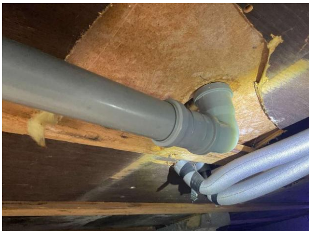
Bild 6: - Utvändigt, Grund, fuktrosor noteras på bjälklagsbottens undersida
