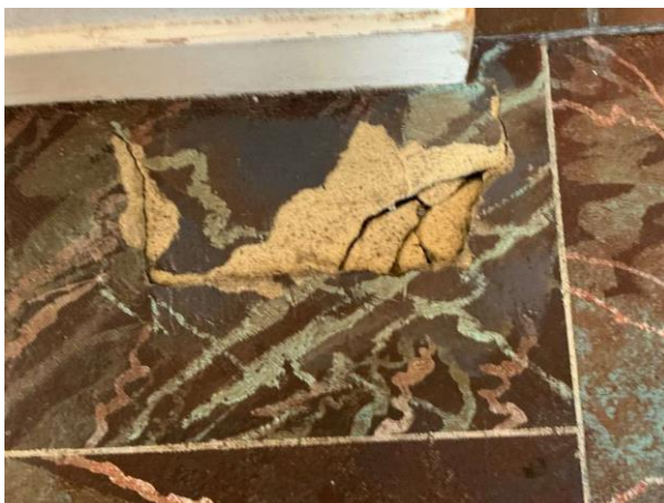
Bild 6: Invändigt, Entréplan, Inre hall, Trasig klinkerplatta noterades
