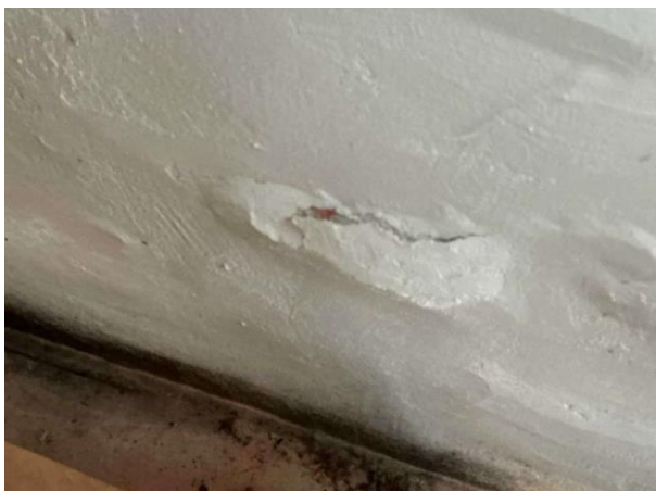
Bild 5: Invändigt, Souterrängplan, Tvättstuga, Äldre våtrum Gjutjärnsgolvbrunn (rost noterades i brunnen) Putssläpp noterades på väggar samt missfärgningar
