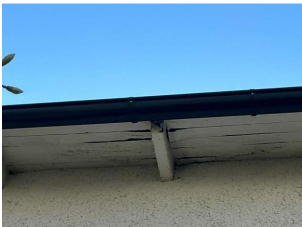
Bild 3: Utvändigt, Yttertak, rötskadad underspikning
