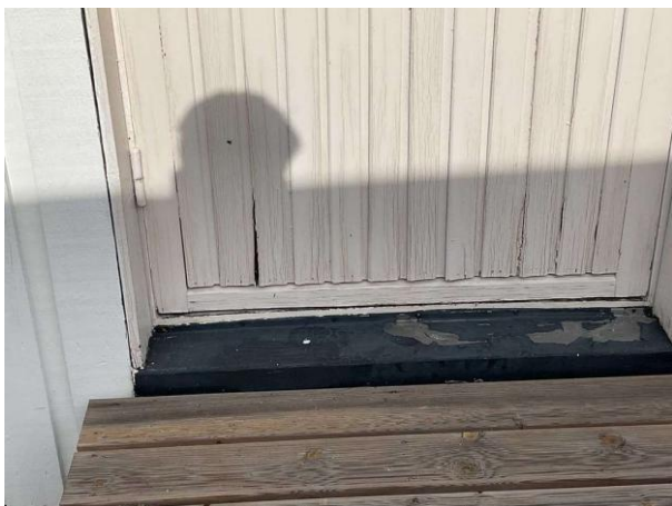
Bild 3: Utvändigt, Ytterdörr, Rötskada panel noteras på groventrén/tvättstugan altandörr
