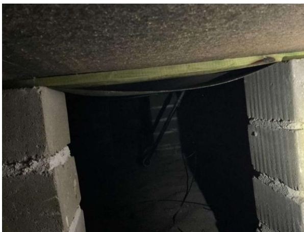
Bild 4: - Utvändigt, Grund, Tryckimpregnerat trä noteras i grunden...
