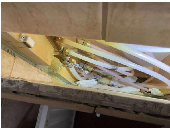
Bild 6: - Invändigt, Entréplan, Inbyggnad för vattenledningar är inte utförd i tätt skåp med läckageindikering. Spricka noteras p...
