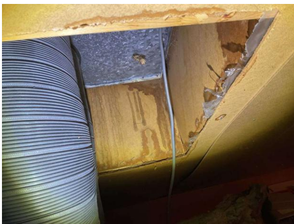
Bild 10: Invändigt, Övervåning, Fuktrosor noteras på skivorna kring ventilationskanalerna (torrt vid besiktningsstillfälet)
