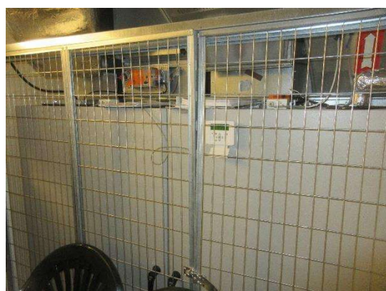
Ventilationsaggregat för dansskolan.
