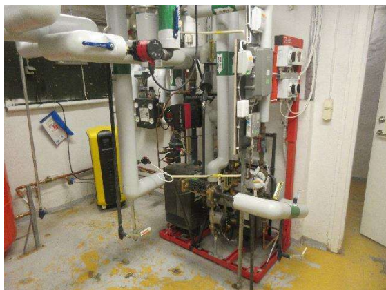
Undercentral för värme och varmvatten
