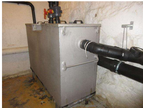
Fettavskiljare för restaurangens avlopp
