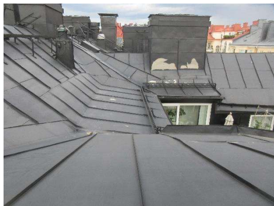
Yttertaken med endast mindre färgsläpp
